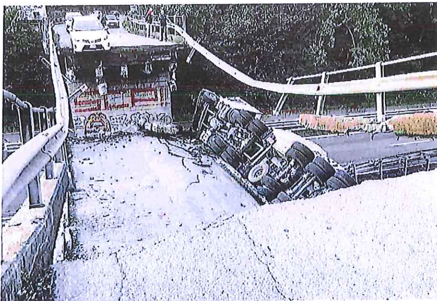
Il ponte di Annone crollato sulla statale 36 della Brianza, il 28 ottobre scorso
